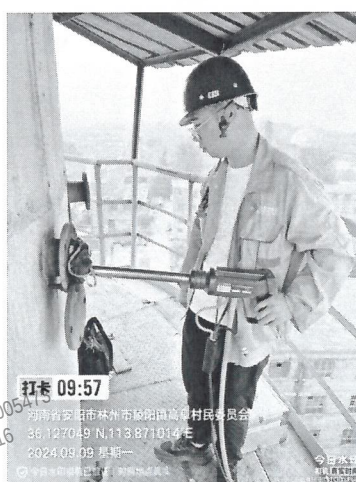
VD精炼、连铸、车间散点废气排气筒出口
